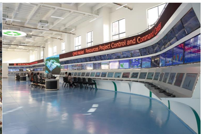
(中央コントロール室)
